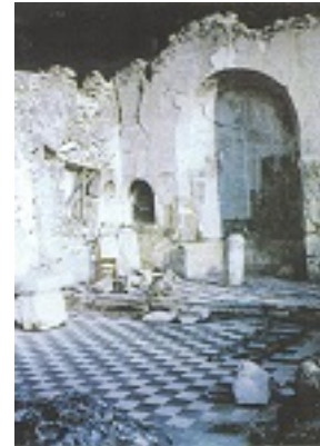
Η παλαιόφατη Ιερά Μονή των Αγίων Φανέντων Σάμης υπέστη μεγάλες καταστροφές στους καταστροφικούς σεισμούς του 1953 μ.Χ. που έπληξαν το νησί της Κεφαλληνίας
