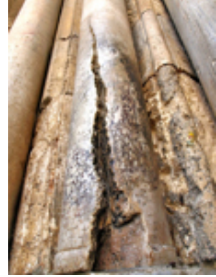
Ο κίονας που διερράγη. Η ρωγμή έχει ύψος 1.20 μ.
