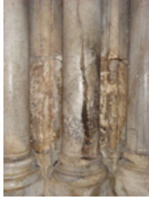
Ο κίονας που διερράγη. Η ρωγμή έχει ύψος 1.20 μ.
